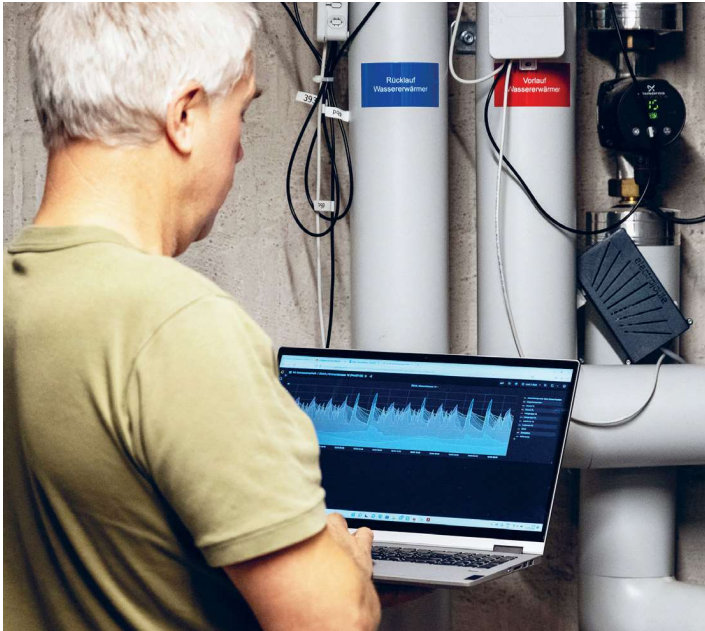
Abbildung 4: Für den optimalen Betrieb von Heizungsanlagen ist die langfristige Messung und Prüfung wichtiger Parameter des Systems unabdingbare Voraussetzung.
