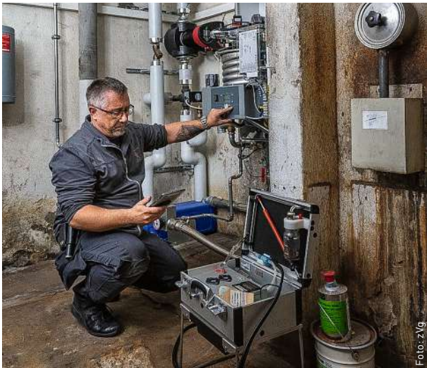
Kaminfeger Peter Gloor beim Service an einer Heizanlage.
